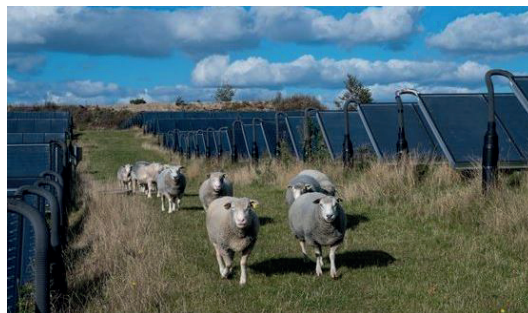
Eksempel på solcelleanlæg med græssende får
