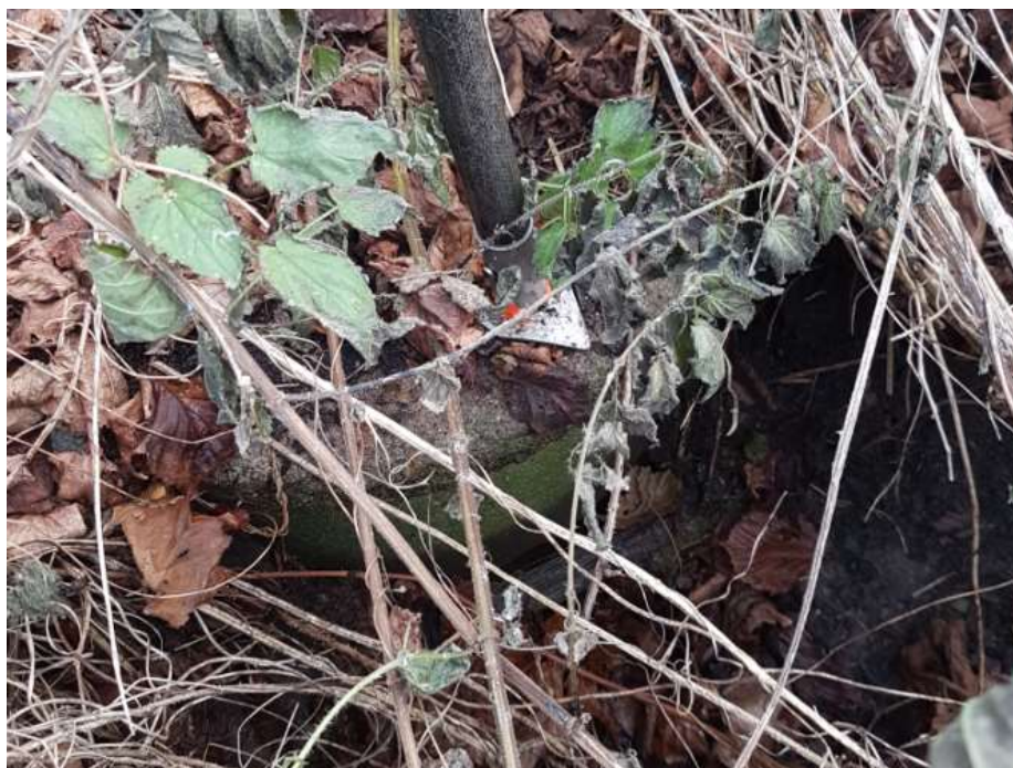
Figur 11. Drænbrønd i afvandingegrøft.
